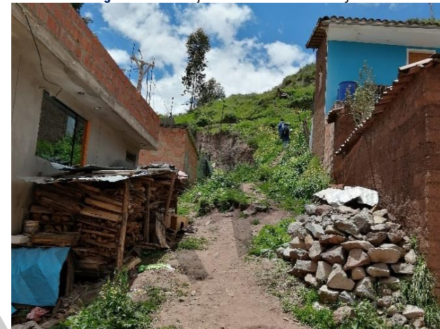
Imagen N° 44: Pasaje 04 de conservación muy mala
